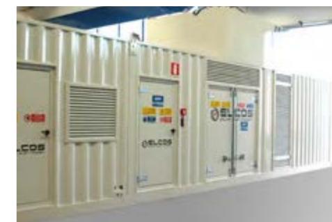
Container 70/75 dbA - 40"HC 1700 kVA Perkins
